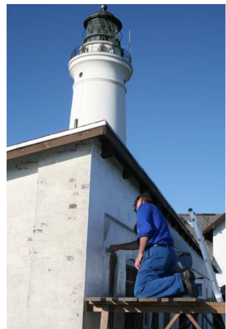
Fyrets Vedligehold var i gang med penslen i de sene sommeraftener, hvor malingen, sponsoreret af Nordsjø Farve, blev smurt på garage og maskinhus.
